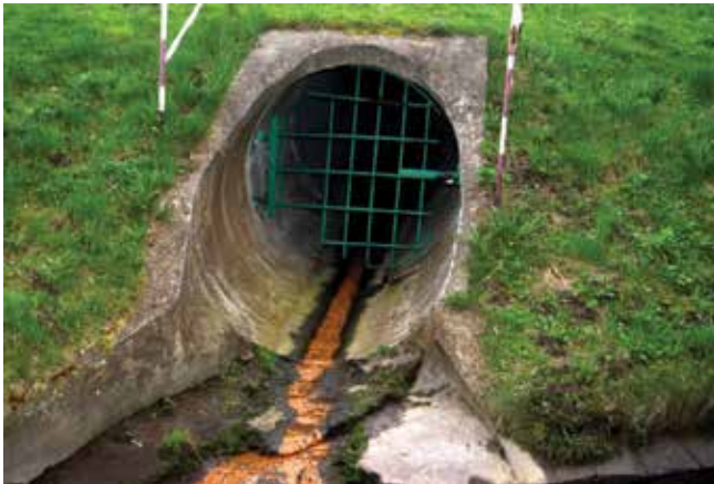
An effluent pipe.
