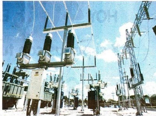
PLAZO. La Empresa de Energía de Bogotá tendrá 15 años para desarrollar el proyecto de infraestructura para la transmisión de energía.
